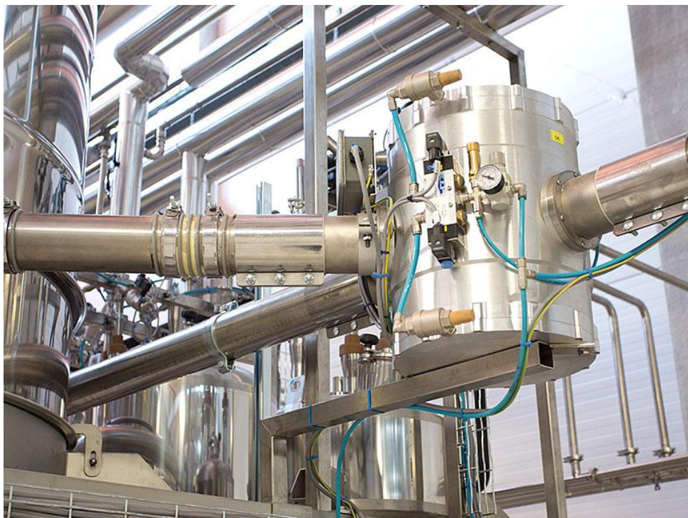
Figura 11: Deviatore Lift CEPI
